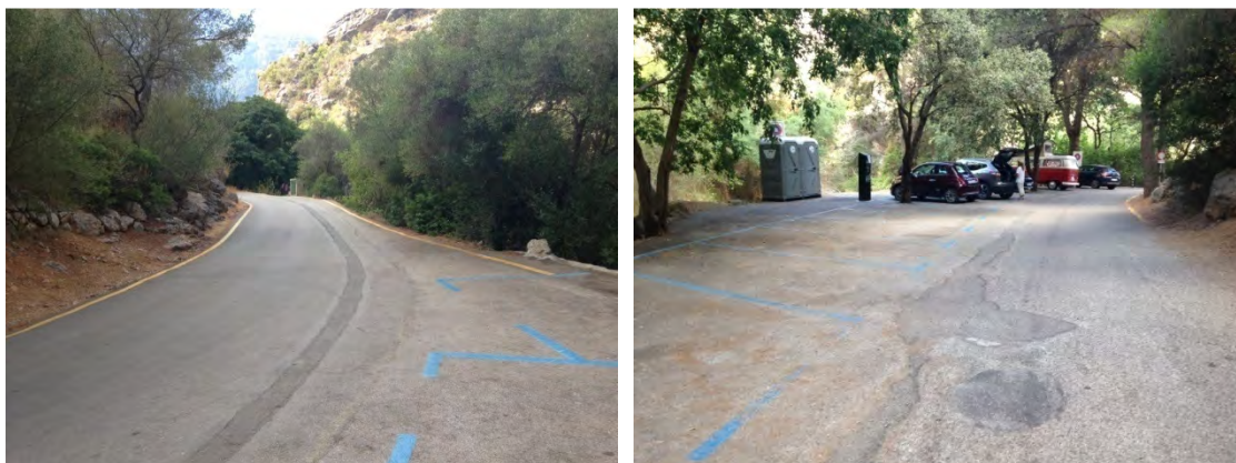
Zanja y parches sobre el vial de acceso a la Cala de Deià.
