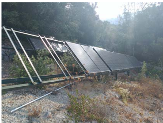
Figura nº4. Instal·lació fotovoltaica connectada a xarxa.
